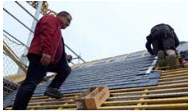
Panneaux thermiques sous une couverture en ardoises, au sein d'un Site Patrimonial Remarquable à Vendôme (41).
